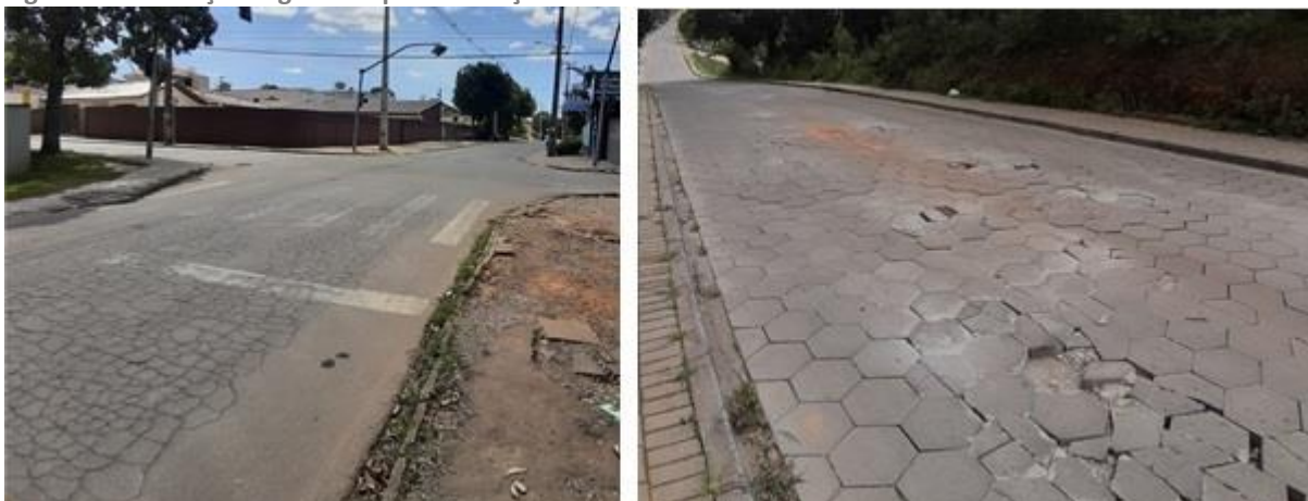
Figura 102: Situação regular da pavimentação na Rua Brasília Moura Leite e Rua Francisco Rocha
