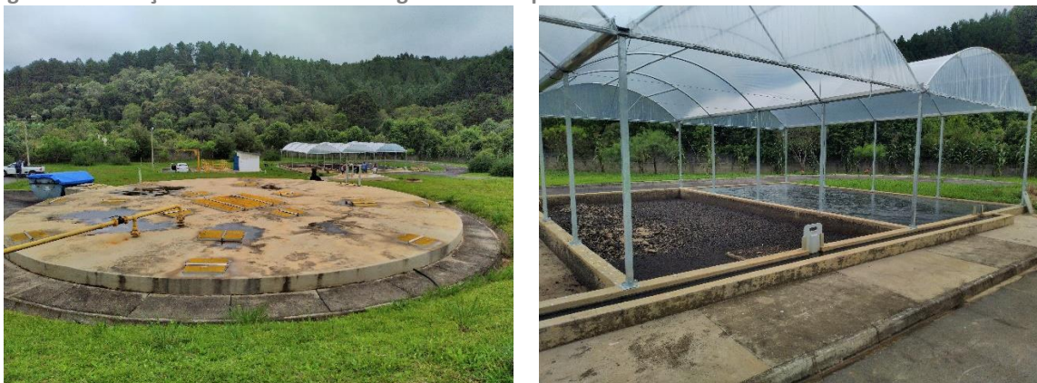
Figura 116: Estação de Tratamento de Esgoto – ETE Tapera na sede urbana
