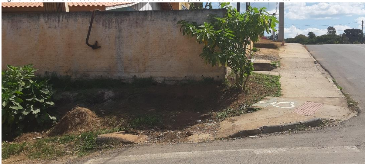
Figura 106: Guia rebaixada em mau estado de conservação, na Rua Luiz Alves de Britto
